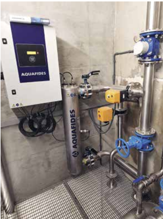
UV-Anlage Trinkwasserbecken Soyreith
